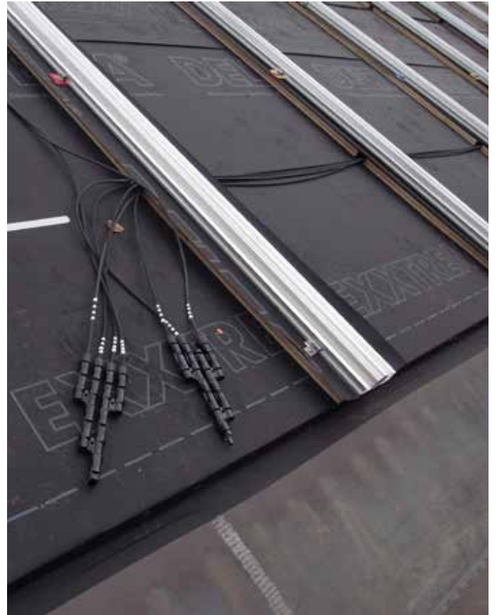
Unterkonstruktion der Module
