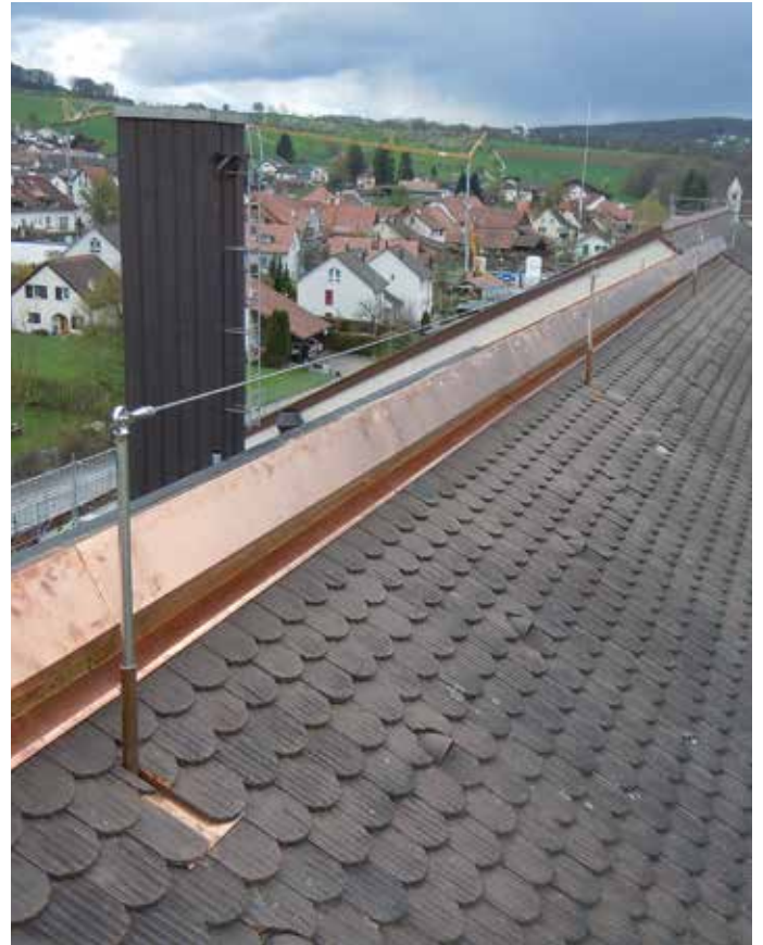
Absturzicherung (System LUX-top)
