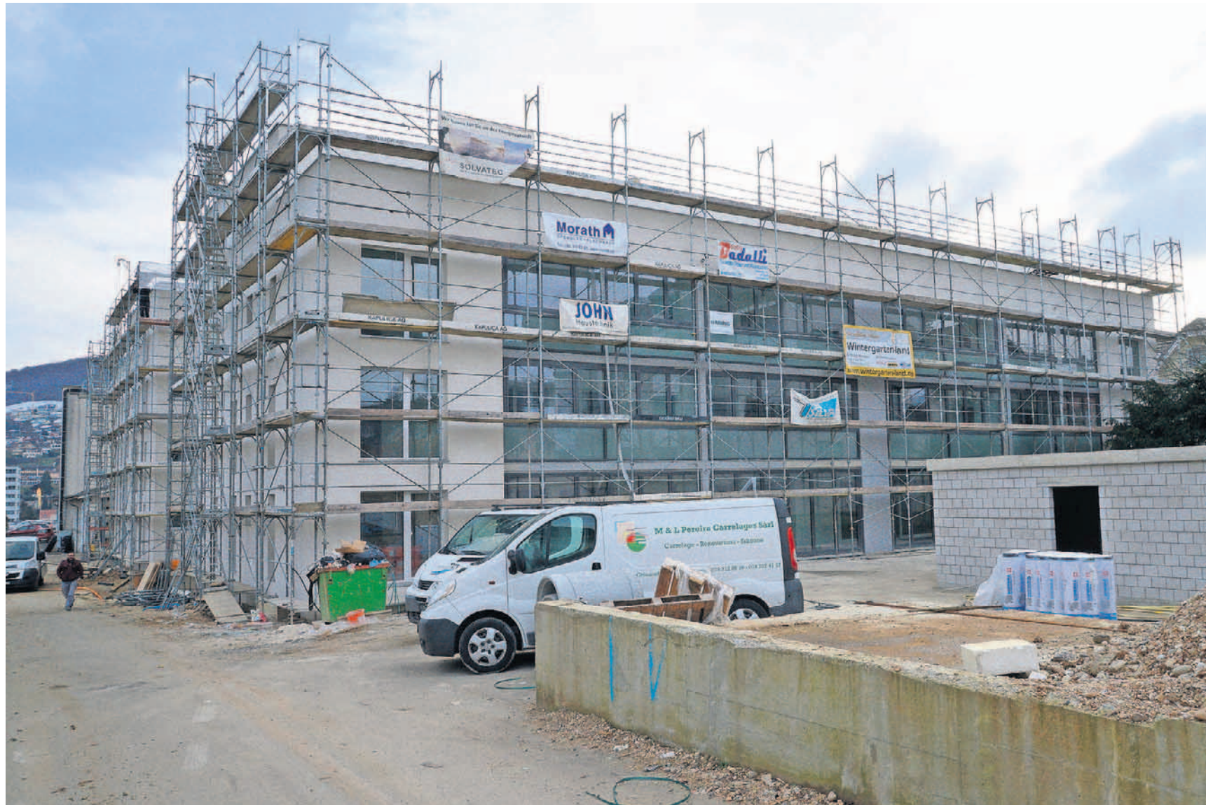
Die beiden fast bezugsfertigen Gebäude des Ergolzpark in Frenkendorf sind die ersten Baselbieter Mehrfamilienhäuser, die als Eigenverbrauchsgemeinschaften mit 30 Wohnungen konzipiert wurden. Auf den Dächern sind je 26,7 Kilowatt Peak installiert. Somit konnte die Anlage mit Einmalförderung und unter Verzicht auf KEV gebaut werden. Da man den Solarstrom auch für die Wärmepumpen nutzt, wird er zu einem grossen Teil in den Häusern verbraucht.
